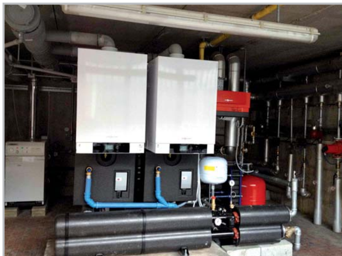
Centrale termica Camanghè
